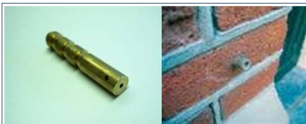
Figuur 5.1: Voorbeeld meetbout (diameter 6 mm) in een gevel (Bron: Gemeente Amsterdam).
