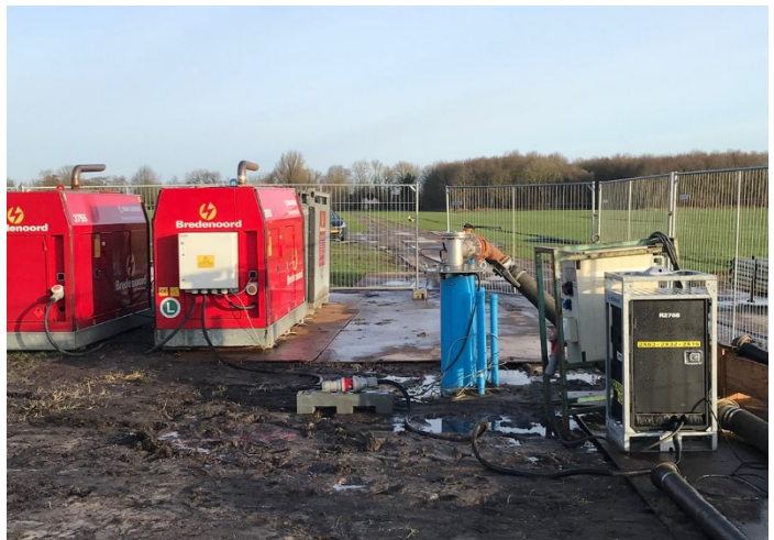
Aansluiting van de pomp
